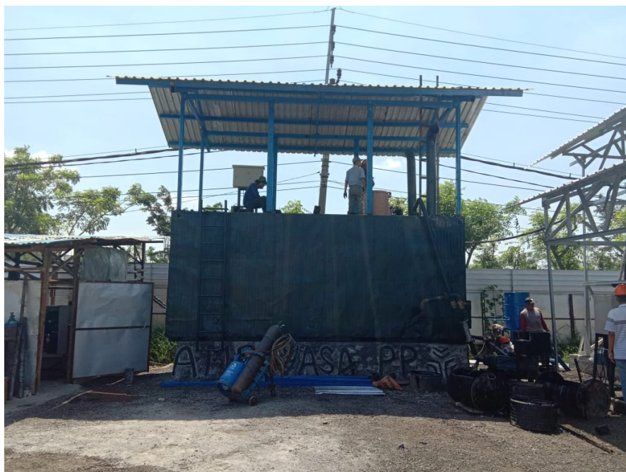
Asbuton Pracampur SBMA menggunakan Ketel berpengaduk dari PT. Summitama Intinusa
